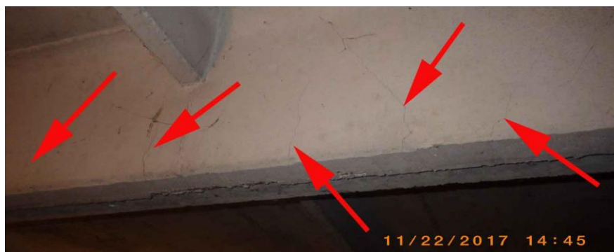
15 paveikslas. 0,1 mm ÷ 0,15 mm pločio plyšiai surenkamos gelžbetoninės denginio plokštės briaunoje
