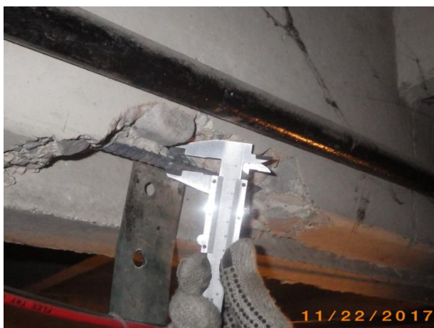
14 paveikslas. Denginio plokštė su numuštu armatūros apsauginiu betoniniu sluoksniu
